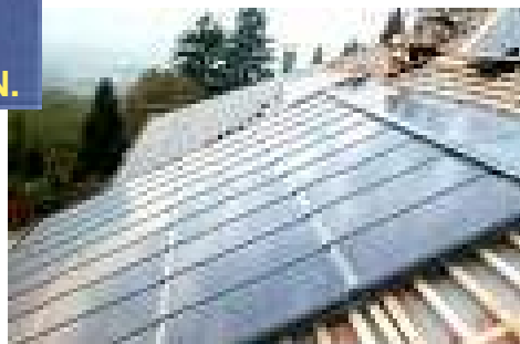
Plaques photovoltaïques, résidence privée
