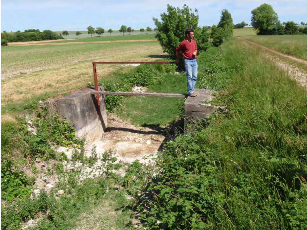
Illustration 26: Le Padome, trop recalibré et aux ouvrages difficilement manipulables
