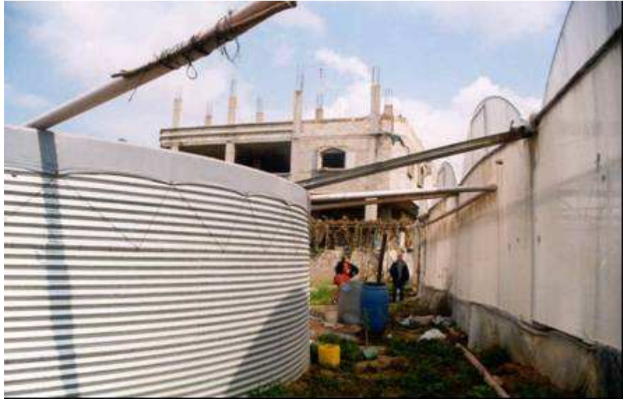
Figure 12 : Récupération des eaux pluviales (eau des terrasses) au profit de l'agriculture urbaine. (Source : PARC – Gaza).
