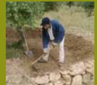
Des participants au programme construisent des cordons de pierres et des cuvettes individuelles pour récupérer l'eau.
