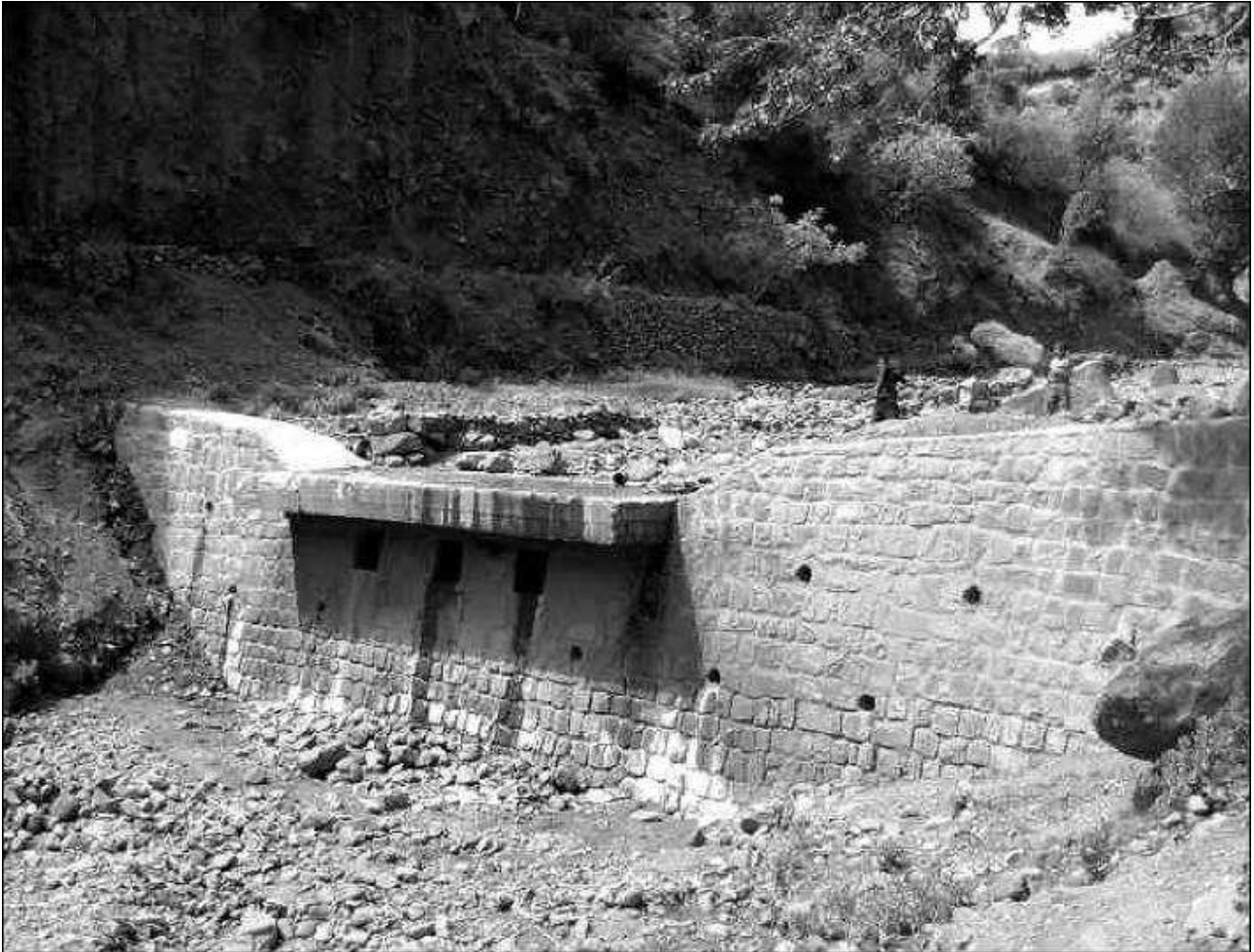
Figure 1.39. Seuil édifié sur l'affluent Tighzirt au Maroc et comblé par la charge solide des crues.
