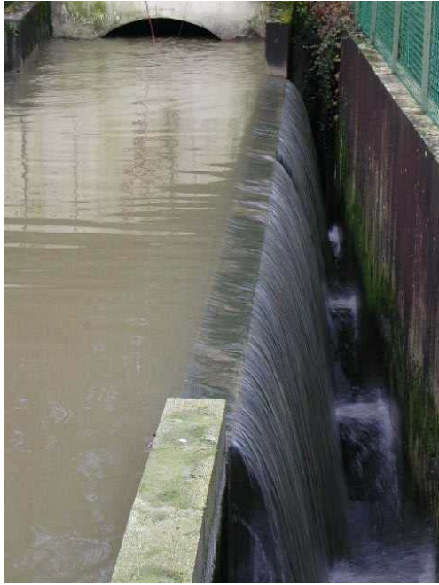
Figure 94 : Déversement au niveau du seuil du DO.
