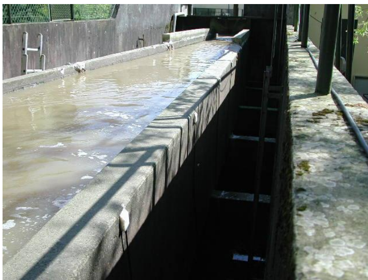
Figure 102 : Rampe de 5 détecteurs de surverse sur le seuil du DO
