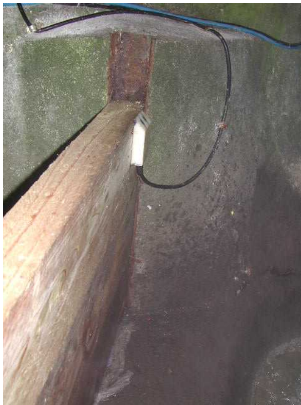
Figure 101 : Détecteur de surverse au niveau du batardeau
