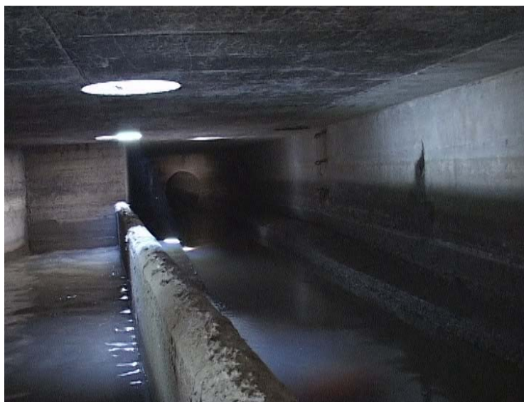
Figure 131 : Déversoir latéral du réseau de Sélestat (DO A)
