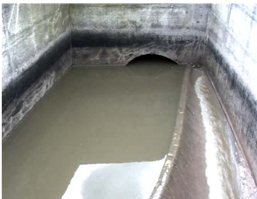
Figure 132 : Déversoir curviligne du réseau de Sélestat (DO 1)
