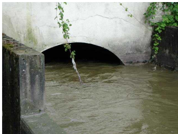
Figure 87 : Débouché du collecteur d'apport dans le chenal du déversoir d'orage
