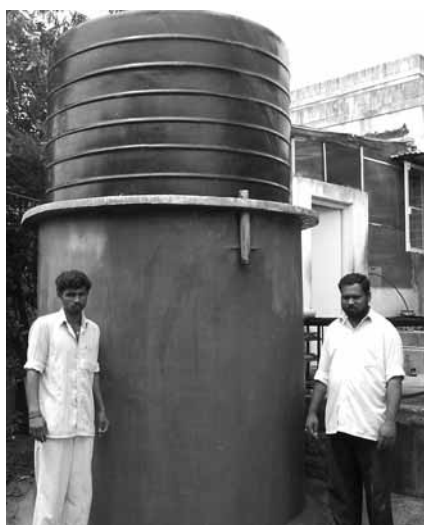
Un grand système de biogaz convenant à un restaurant d'entreprise.
