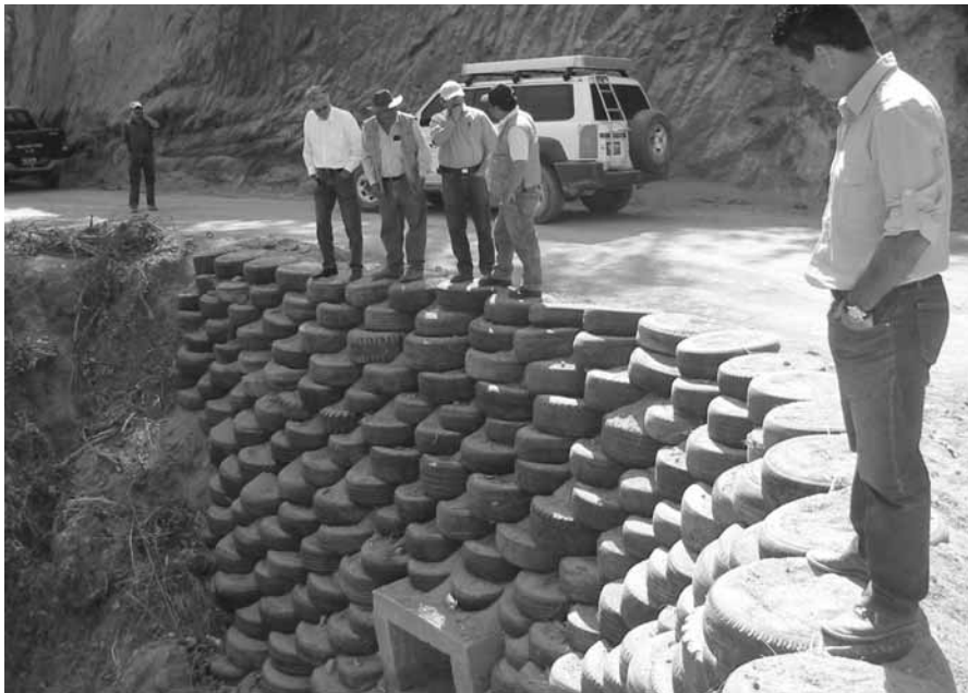
Les routes et les ponts sont stabilisés avec des digues constituées de vieux pneus reliés entre eux par du fil de fer et garnis de terre.
