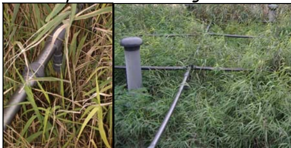
Alimentation par réseau aérien perforé dans sa longueur
