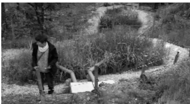
Phyto-épuration chez des particuliers à Monoblet, Cévennes. Un 1er étage à écoulement vertical planté de roseaux, suivi d'un 2ème étage à écoulement horizontal avec diverses plantes.
