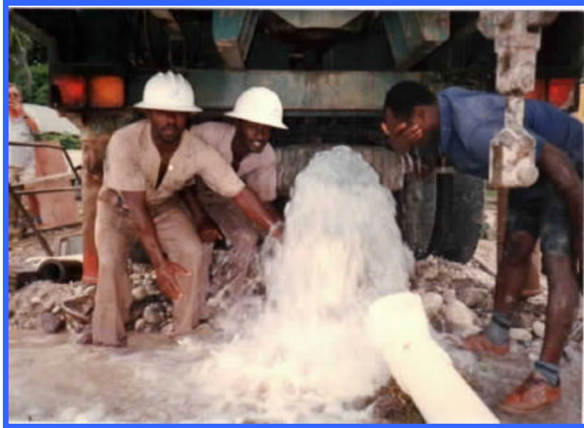
Photo 2.- Un forage artésienisme jaillissant, réalisé à Formon, dans le Sud d'Haïti
