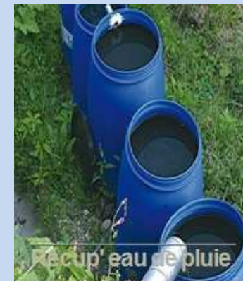
Récupération de l'eau de pluie
