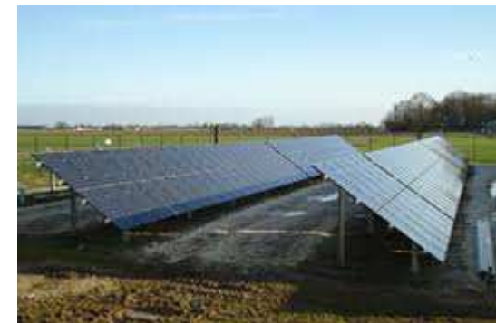
Panneaux photovoltaïques de la Régie de Montdidier ↑
