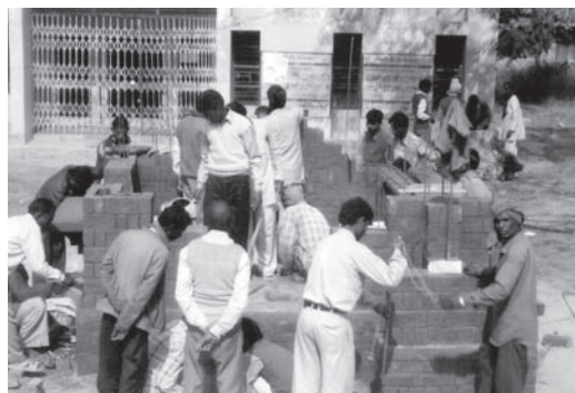
Figure 14: Maçons apprenant des pratiques de construction résistante aux aléas, en Uttar Pradesh
