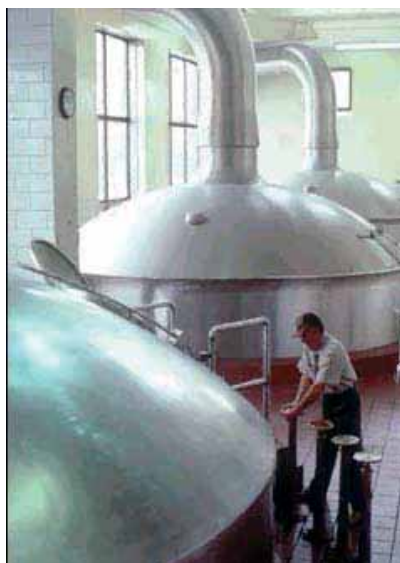
Cuves de brasserie
