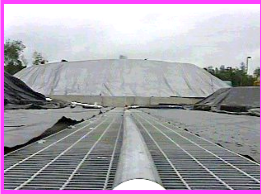
Pile de sol contaminé
