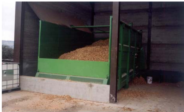
Figure 19 : Silo d'alimentation aménagé dans un conteneur
