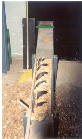
Figure 20 : alimentation de la chaudière par vis sans fin
