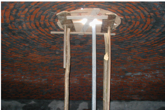
Système interne de maintien des dernières briques
