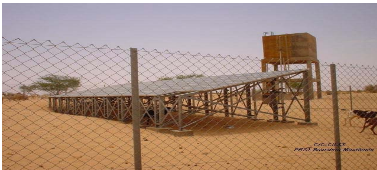
Vue globale d'un système de pompage et de stockage
