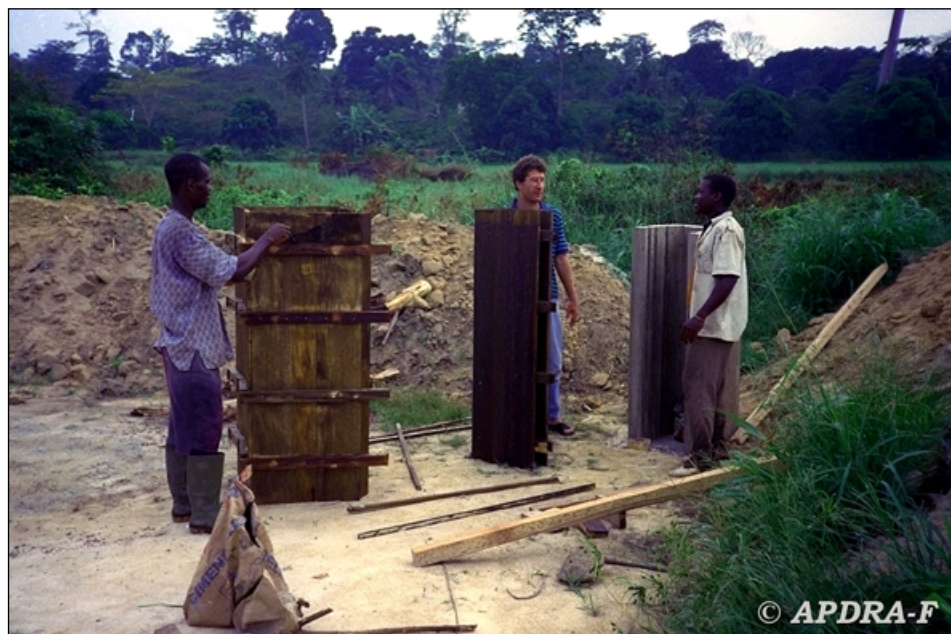
Photo 10 : coffrage en 2 composantes loué aux pisciculteurs.
