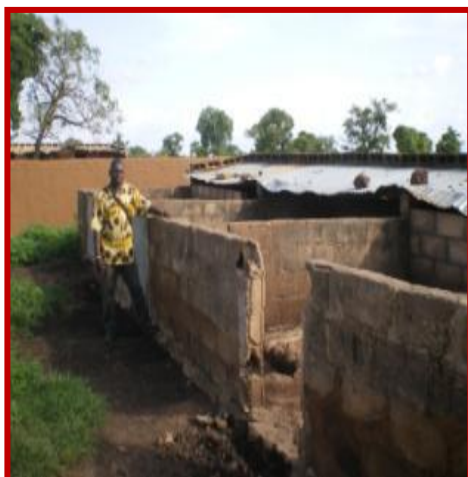
PHOTO 2: Bâtiment d'élevage en forme de L et avec des dégradations avancées (Ouagadougou, Province du Kadiogo)
