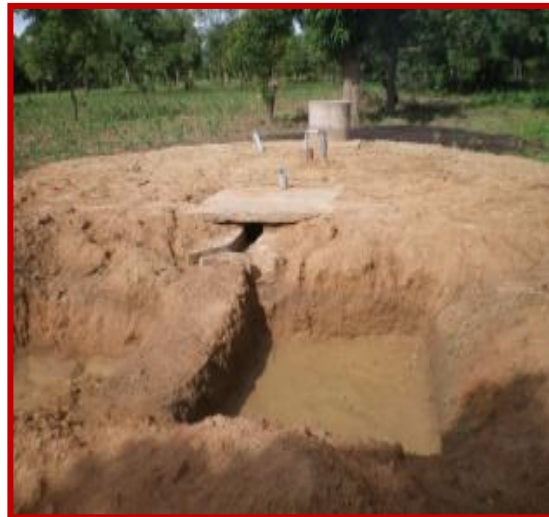
PHOTO 22: Construction d'un digesteur de biogaz dans la ferme de Coulibaly ALLADOUIN à Bobo-Dioulasso.
