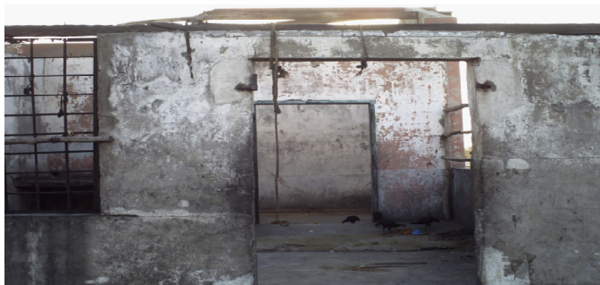
Abattoir de Morondava en état délabré
