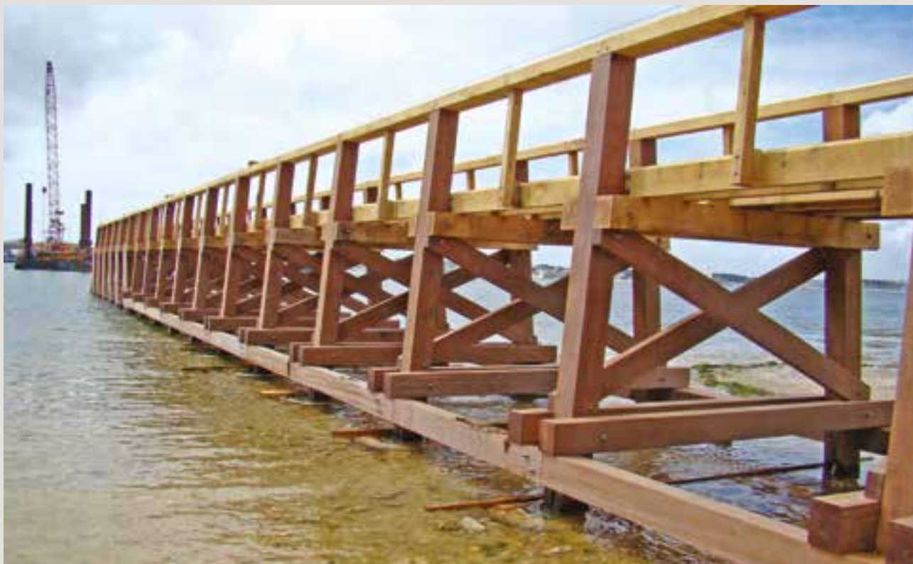
▲ Photo 60 : Estacade © M. Vernay
