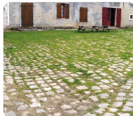
LES PAVÉS SANS JOINT LAISSENT S'INFILTRER L'EAU
