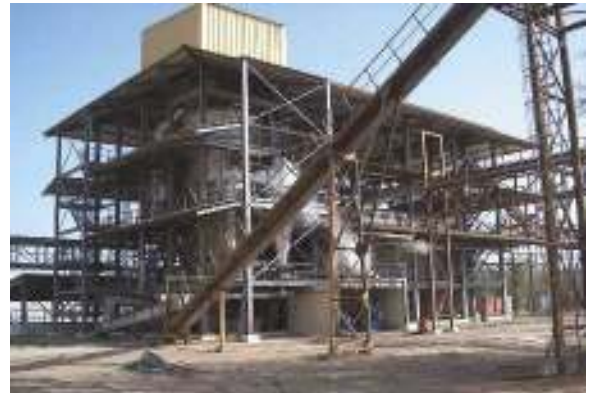
Figure 9 – Installation d'extraction Desmet (Société Huicoma, photo X.Pagès)
