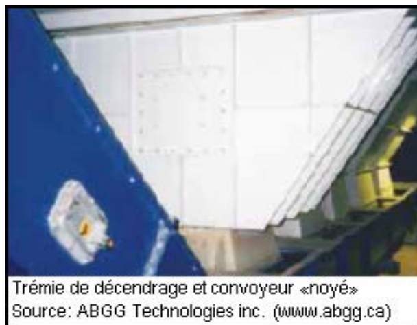
Photo 25 : Trémie de décendrage et convoyeur immergé
