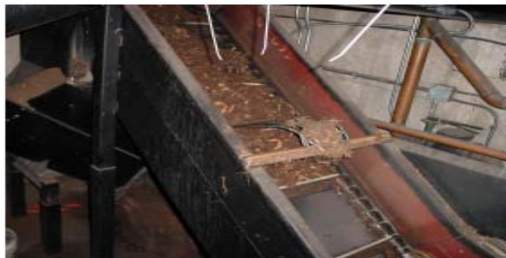
Convoyeur à chaînes Source : KMW Systems Inc. ( www.kmwenergy.com )
