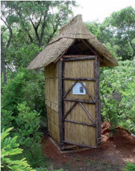
Photo 3-1 : Latrine à compost simple construite sur une dalle rectangulaire.
