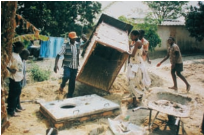
Photo 4-19 : Adaptation d'une superstructure mobile à une fosse de Fossa alterna .
