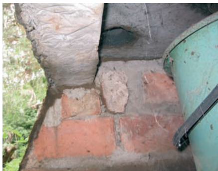
Photo 6-55 : Toiles d'araignée à l'intérieur de la fosse
