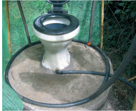
Photo 7-8: Le tuyau de déviation des urines attaché à la base d'un siège.
