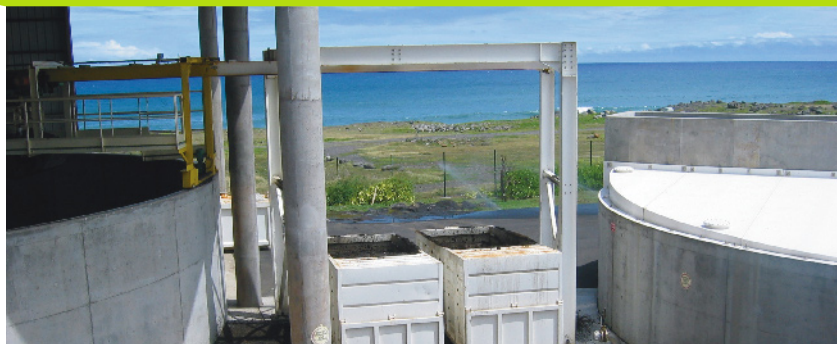
Fosse de séchage et conteneur de boues pour le chargement (Saint-Pierre). © V. van de Kerchove
