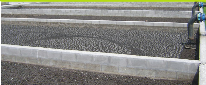
Lit de séchage des boues de station d'épuration (Saint-Leu). © V. van de Kerchove
