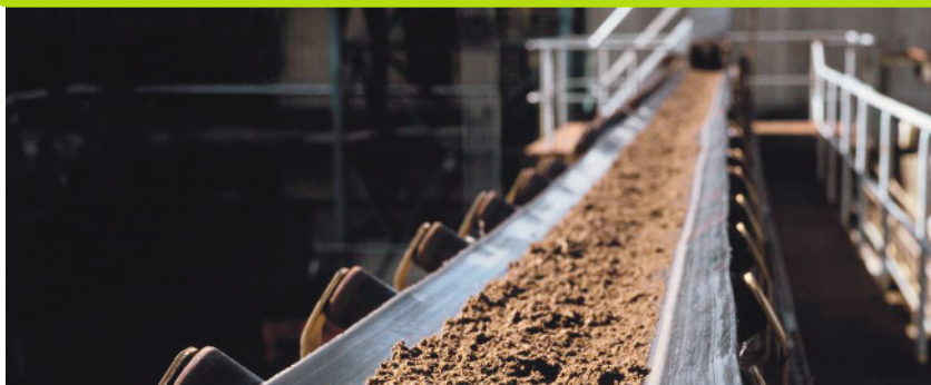
Tapis d'évacuation des écumes dans l'usine. © CEDUS
