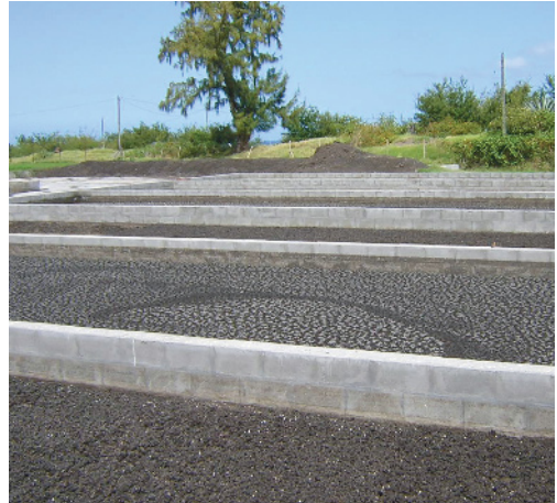
Lits de séchage de la boue. © V. van de Kerchove
