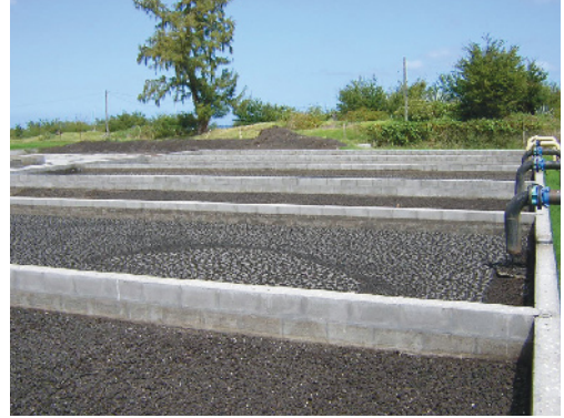
Lit de séchage des boues de station d'épuration à Saint-Leu. © V. van de Kerchove
