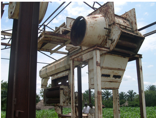
Figure 23 : Vue de l'usine délabrée de N'Gandajika (Kasaï Oriental) installée dans le cadre du projet de remplacement des usines d'égrenage en RDC.
