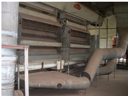
Figure 28 : Vue des égreneuses et de la tuyauterie délabrée d'une usine de la Cotonnaire non récupérable à N'Gandajika (Kasaï Oriental).
