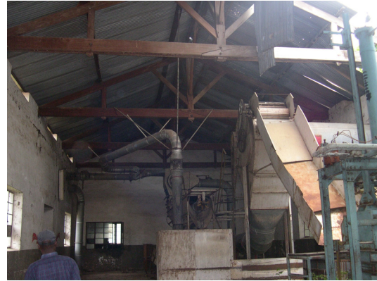
Figure 27 : Le bâtiment délabré de l'usine de La Cotonnaire à Wamaza dans le Maniema.
