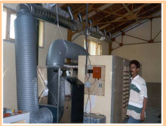
Photo 2: Le chauffage complémentaire
