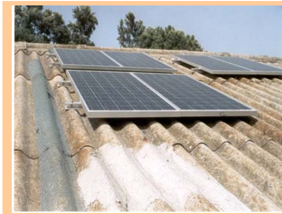
Photo 1: Les cellules photovoltaïques sur le toit
