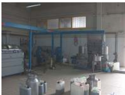
installation d'extraction moderne automatisée à cycle continu.
