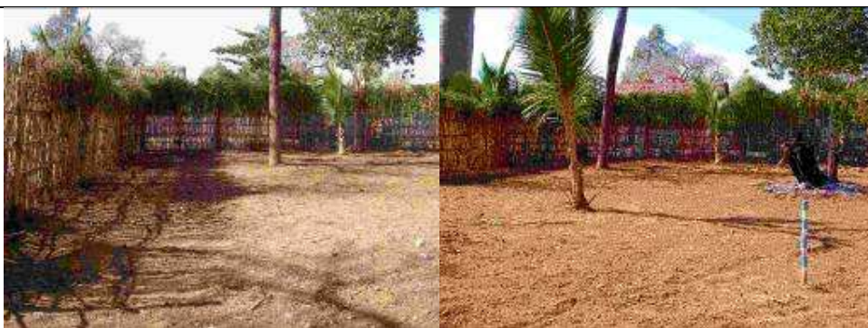
Figure 3 : Site après nettoyage.
