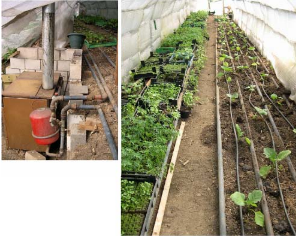
Illustration 5 : Le système "bricolé" par Rudolf permet de chauffer la serre des semis précoces. La circulation du flux se fait par différence de potentiel : l'eau très chaude à la sortie de la chaudière à bois va pousser l'eau moins chaude des tuyaux pour chauffer le sol et l'atmosphère de la serre.
