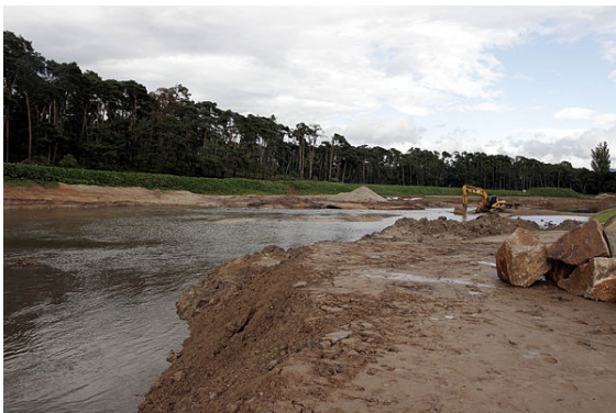
Début des travaux de renaturation (2006/2007) de la Weschnitz à Einhausen (Allemagne), en 2007
