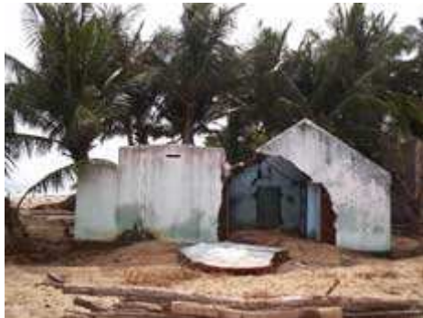
Maison en Inde détruite par le Tsunami de décembre 2004 Auroville Tsunami Relief ©
