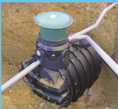
Citerne de récupération d'eau pluviale
