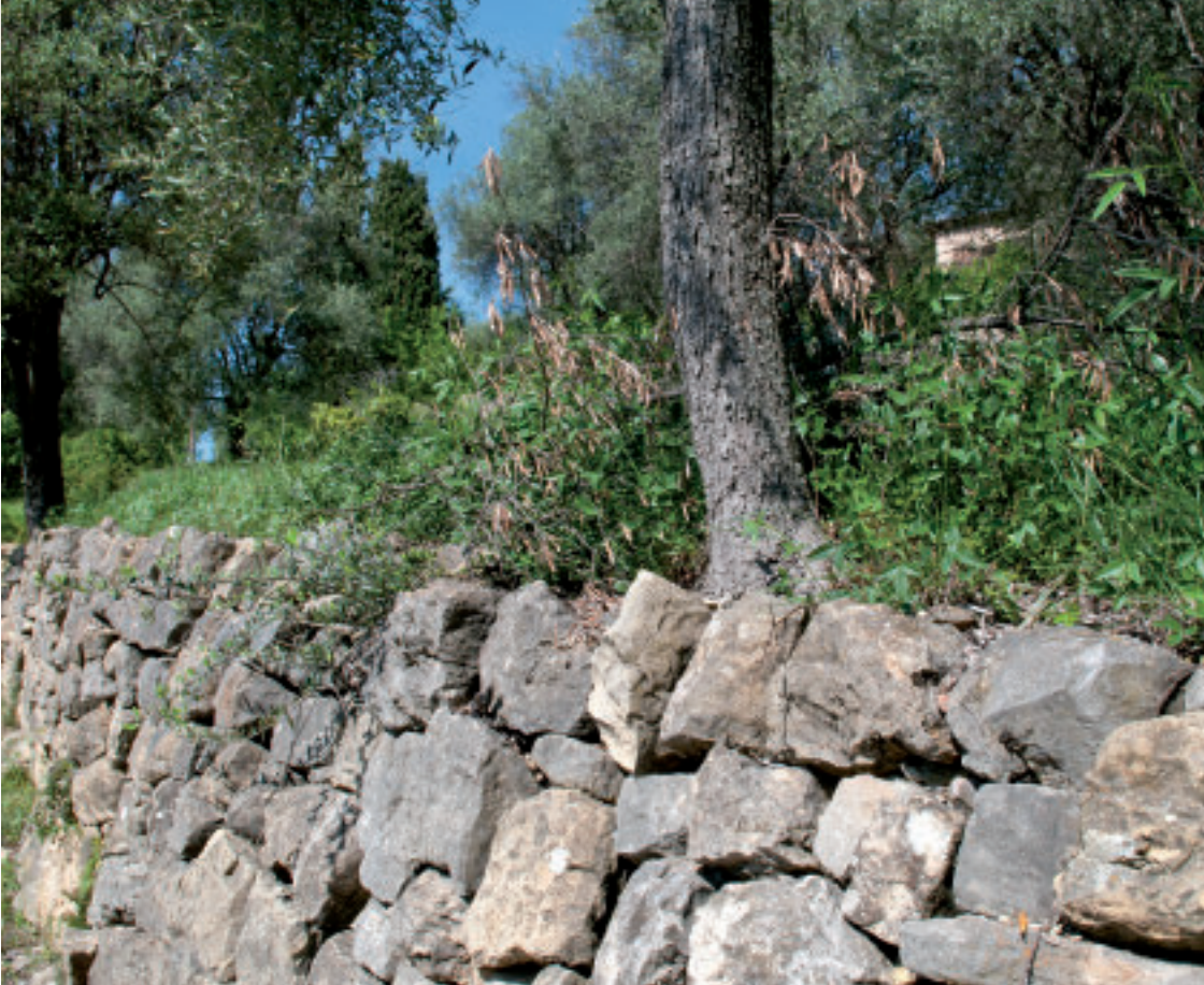
Oliviers plantés en bordure de mur : leurs racines risquent de l'endommager, Opio. David Vincendeau, CASA.
