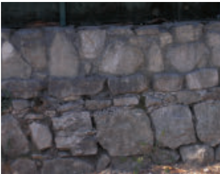
Le bas du mur est conforme à l'esthétique des murs en pierres sèches tandis que sur le haut les joints en ciment sont trop visibles, CAPAP.
