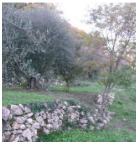
Terrasses dégradées – « raccourci » au droit de l'arbre. Ginger strategis.
