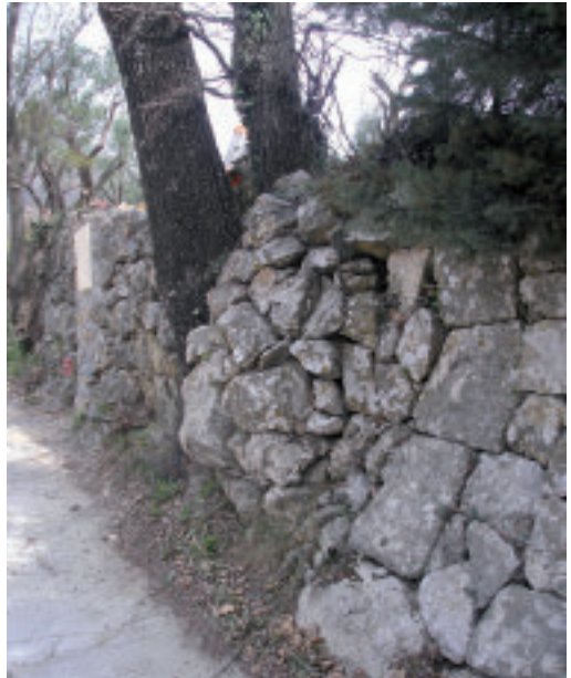
Dégradation du mur en pierres sèches par le chêne qui s'y est implanté. Marie Gautier, CRPF.
