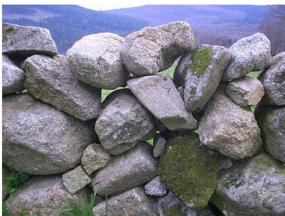
Sainte-Feyre (Creuse) : murette consistant en une épaisseur de pierres arrondies simplement empilées à sec.
