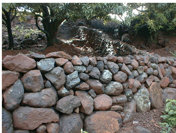
San Ramon, Choluteca, Honduras : mur champêtre à empilement de blocs arrondis et à fruit très marqué sur les deux faces ; les blocs sont de hauteur décroissante de la base au sommet.
