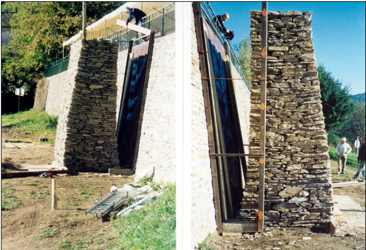
Figure V-15 : vues de la déformée finale du mur 5 (en forme de « ventre ») après avoir enlevé le coffrage.
