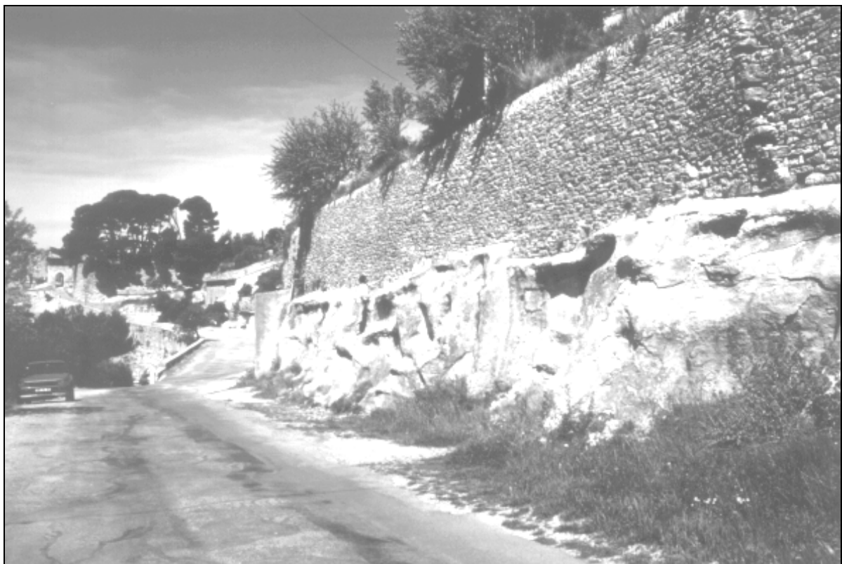
Figure I-2 : mur de soutènement en pierres sèches (Bonnieux –Vaucluse) fondé sur le rocher affleurant.
