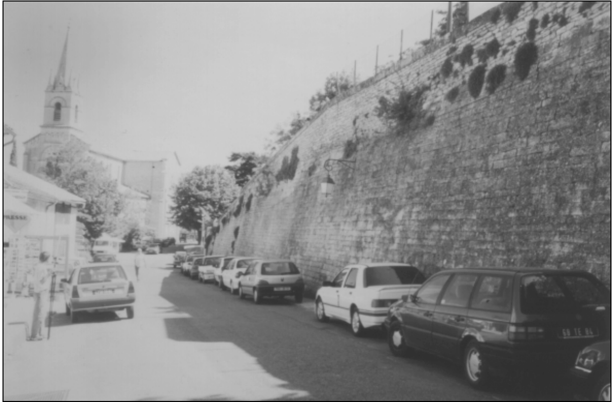
Figure I-4 : mur de soutènement routier calcaire en pierres sèches de taille (Bonnieux -Vaucluse).
