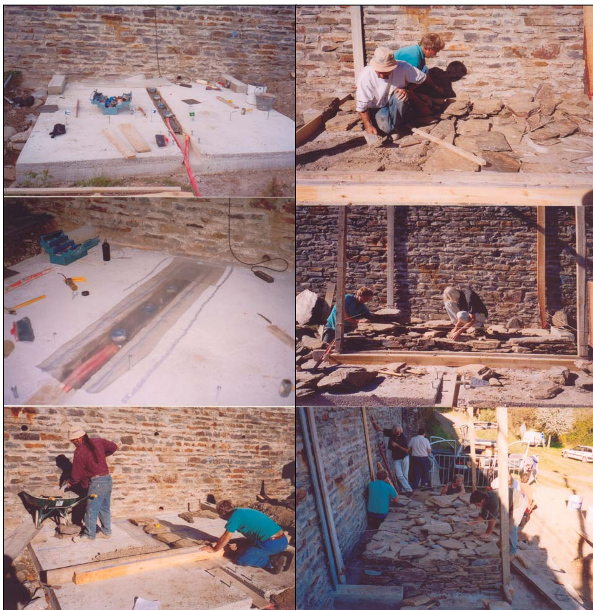
Figure V-2 : étapes du montage du mur ; à gauche de haut en bas, (a) pose des capteurs de force, (b) pose de l'étanchéité, (c) pose des pierres sur les capteurs de force ; à droite de haut en bas, (d) croisement des joints sur les pierres posées sur les capteurs, (e) construction de la base du mur, (f) étape intermédiaire de la construction.
