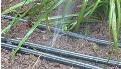
Fuites dans les lignes de goutte à goutte de micro-irrigation
