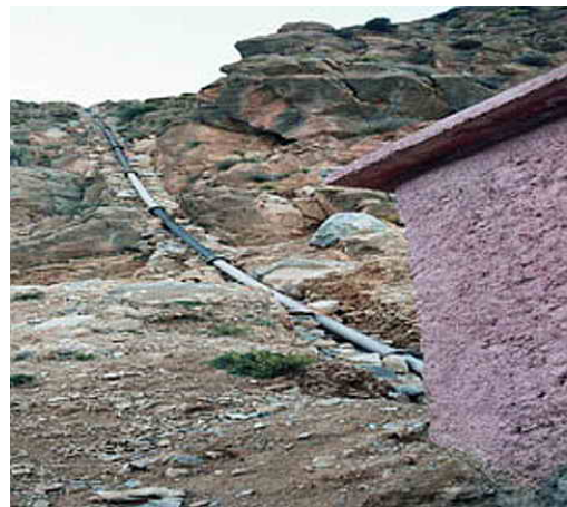
Fig. 2: Conduite forcée et centrale
