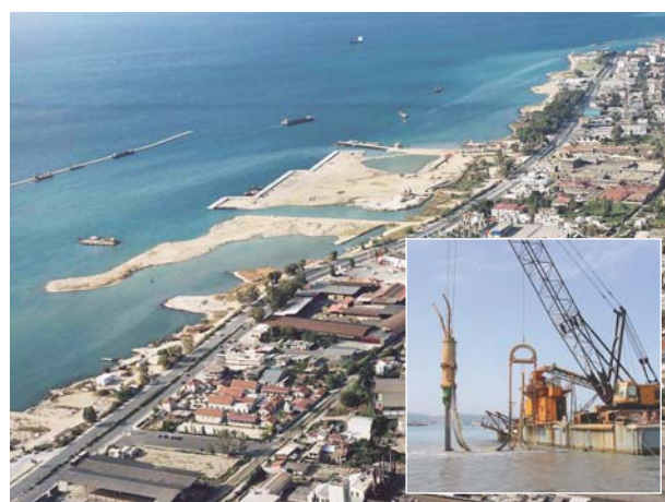
GRÈCE - Port de Patras Jetée de 1 000 m de long et quai de 500 m de long
