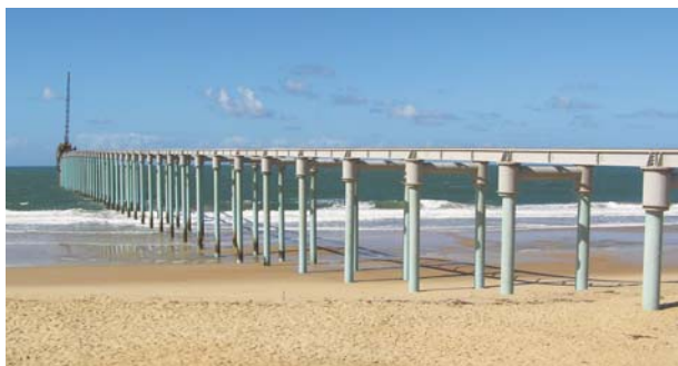
MOZAMBIQUE - Appontement de Moma Sands Jetée de 412 m de long dans l'Océan Indien
