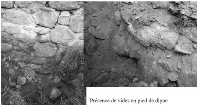
FIGURE 14 : DÉMARRAGE DE L'AFFOUILLEMENT (EXTRAIT DE [2])
