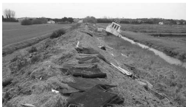
FIGURE 6 : LAISSES DE SUBMERSION SUR DIGUE – LA BARRE-DE-MONTS (85)
