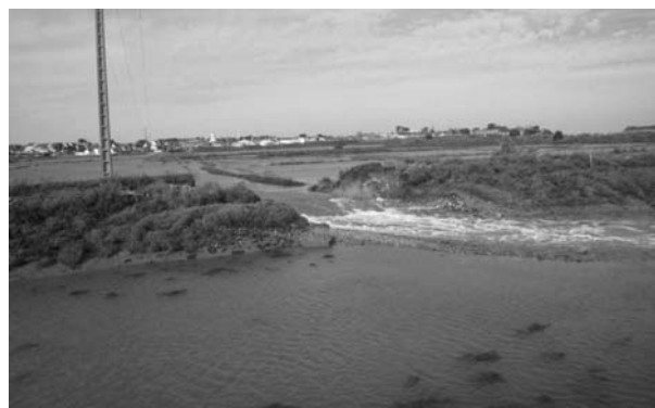
FIGURE 5 : BRÈCHE TOTALE SUR LA DIGUE DE PROTECTION DES MARAIS DE GUÉRANDE - BATZ-SUR-MER (44)
