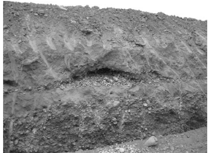
FIGURE 7: LENTILLE DE GRAVE PRÉSENTE À LA BASE DE LA DIGUE DE LANGLADE.
