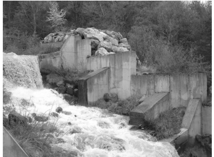
FIGURE 1. DIGUE COMPOSITE À PAREMENT EN BÉTON ARMÉ EN PARTIE AMONT DU DISPOSITIF (TRONÇON 2-RG).
