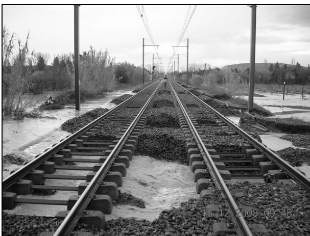
PHOTO 4 : BRECHE DANS LE REMBLAI DU COULON (2009)
