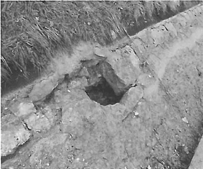
FIGURE 4 : EXEMPLE DE SOUS-CAVAGE TRES IMPORTANT DANS LA PARTIE SUPERIEURE DU PERRÉ.
