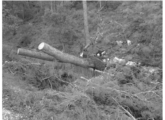
PHOTO 1 : PIN D'ALEP RENVERSÉ PAR LE VENT, AYANT IMPORTÉ LES DALLES BÉTONNÉES DU CANAL SUR PLUSIEURS MÈTRES DE LONGUEUR
