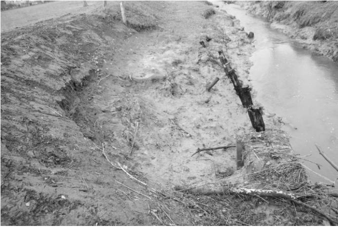
FIGURE 5: VISUALISATION DE L'EFFONDREMENT DE L'OUVRAGE ET DE LA PRESENCE DES PIEUX D'ORIGINE A LA BASE DU TALUS DE RISBERME.
