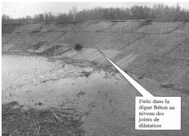
PHOTO 7 : DIGIE DE L'OISELET - VUE DU TALUS AVAL LORS DE CRUE DE 2003.
