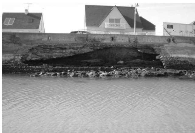
FIGURE 2 : DÉVELOPPEMENT EXCESSIF D'UNE CAVITÉ DANS LA DIGUE D'ASNELLES - MAI 2011
