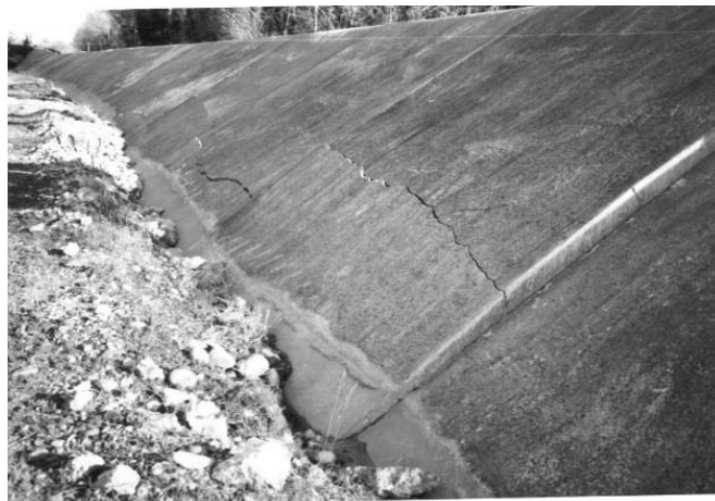
PHOTO 1 : ETAT DES LIEUX DE LA DIGUE EXISTANTE A VIVIERS EN MARS 2004
