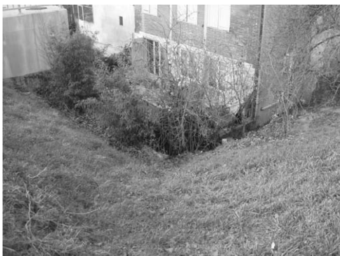
FIGURE 3: VUE D'HABITATION EN PIED DE DIGUE.
