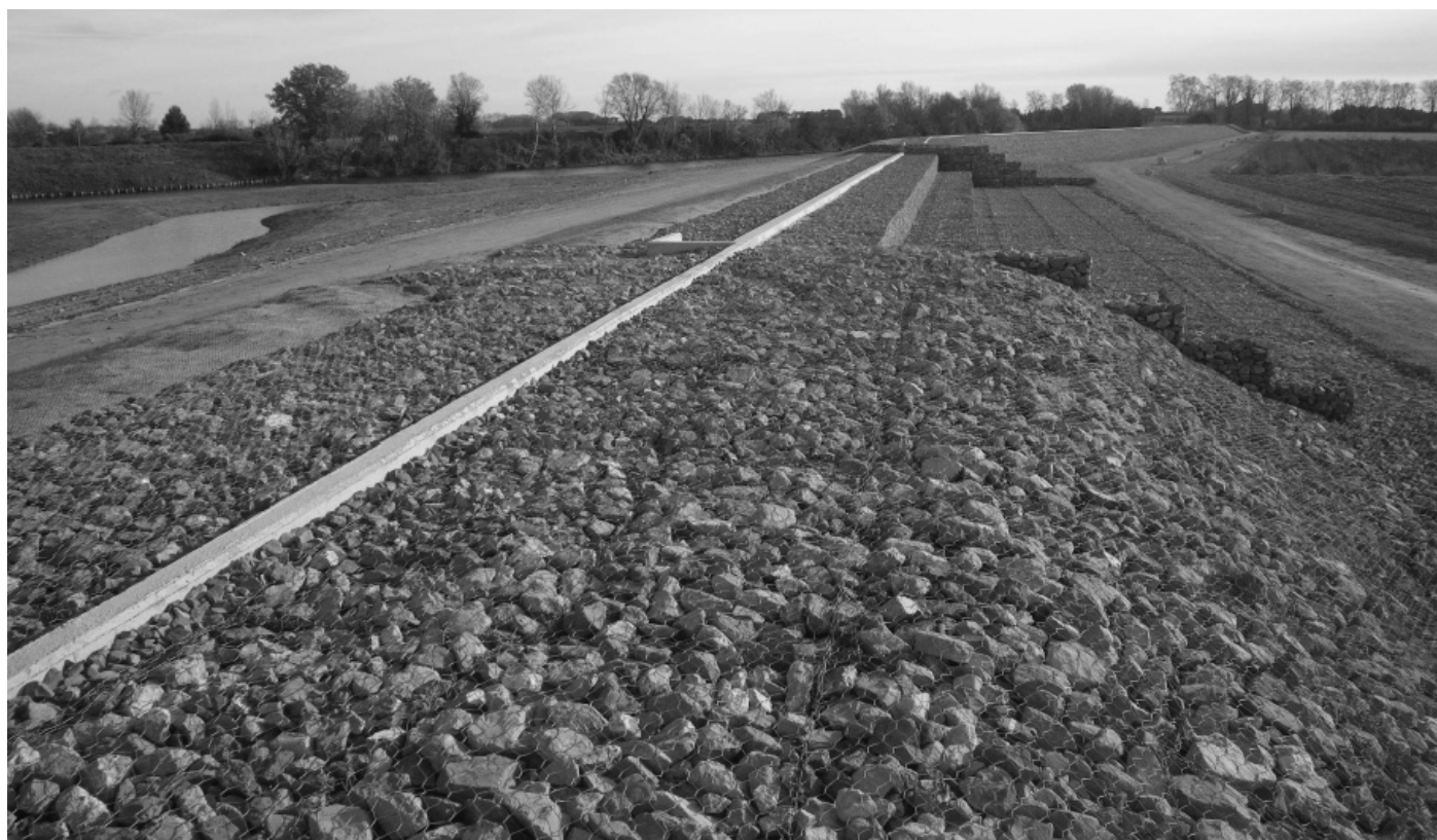
FIGURE 12 : PHOTO D'ENSEMBLE DU DÉVERSOIR EN GABIONS
