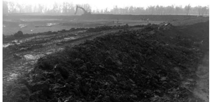
FIGURE 8 : VUE D'UNE RÉPARATION DE BRÈCHE EN ARC DE CERCLE, BRÈCHE DAUZAC (AUTEUR : F. CLÉMENT, CETE DU SUD-OUEST)
