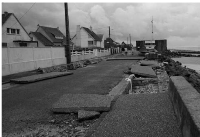
FIGURE 5 : DÉGÂTS SUR LA DIGUE DE VER-SUR-MER SUITE À XYNTHIA
