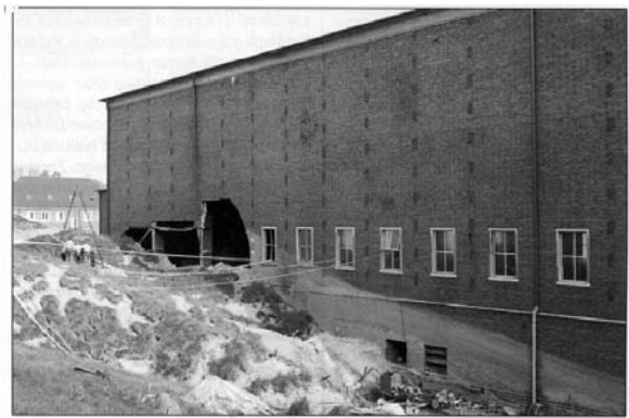
FIGURE 6: INSTABILITÉ FRAPPANT L'USINE DE DYCHÓW
