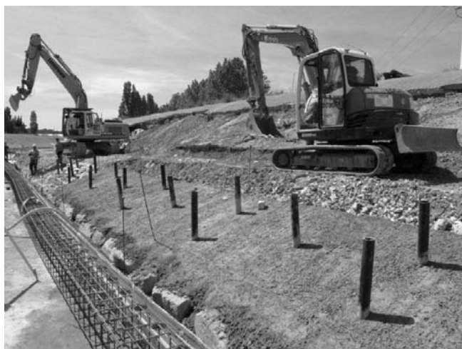
FIGURE 13: FERRAILAGE DE LA LONGRINE APRÈS RÉALISATION DU PIED DE DIGUE EN ENROCHEMENTS LIAISONNÉS AU BÉTON ET POSE DES BARBACANES
