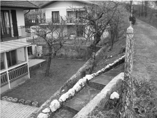
FIGURE 2 : TALUS AVAL DE LA DIGUE OCCUPE ET DÉCAISSÉ PAR LES TERRAINS DES PROPRIÉTAIRES RIVERAINS
