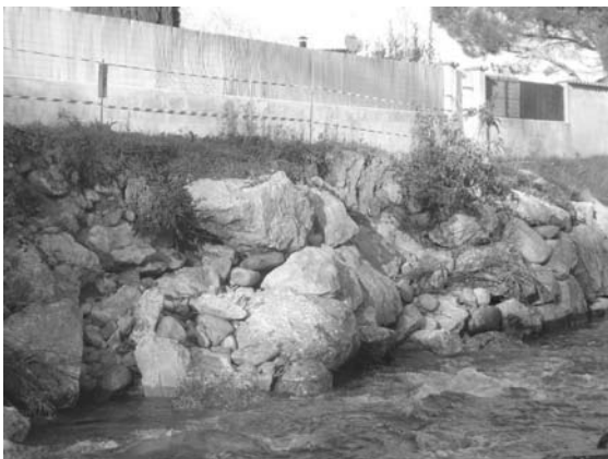
FIGURE 8 : DÉGÂTS SUR LES ENROCHEMENTS DE LA DIGUE DE LA CITÉ DES 150 APRÈS LA CRUE DE NOVEMBRE 2011
