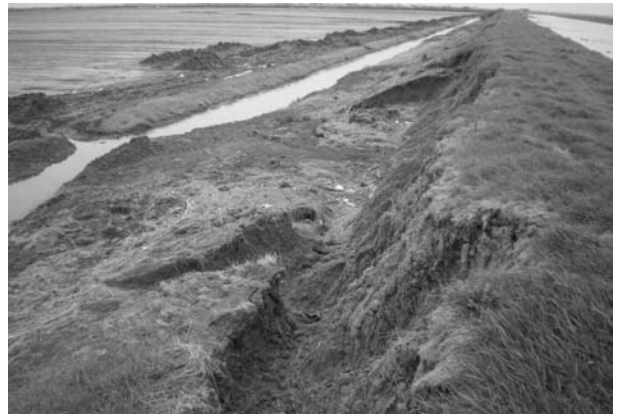
FIGURE 9 : GLISSEMENT D'ENSEMBLE DU TALUS CÔTÉ TERRE DE LA DIGUE D'EN BAS DE LA BAIE DE L'AIGUILLON - PUYRAVAULT (85)
