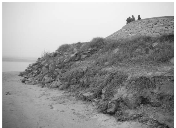
FIGURE 12 : EPERON N°24 DE LA DIGUE DE PROTECTION MONTRANT UNE FORTE ÉROSION EXTERNE A SON PIED.
