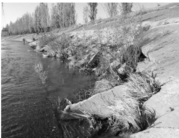
FIGURE 3: DISLOCATION DES DALLES EN PIED DE DIGUE SUITE À L'ÉROSION DES LONGRINES
