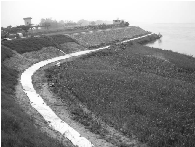
FIGURE 16 : LA BANDE CAPTEUR TEXTILE FIBRE OPTIQUE INSTALLÉE SUR L'OUVRAGE
