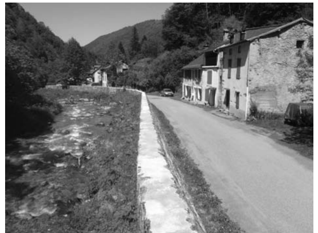
FIGURE 10 : CRÊTE DE LA DIGUE RIVE DROITE DU SALAT À COUFLENS
