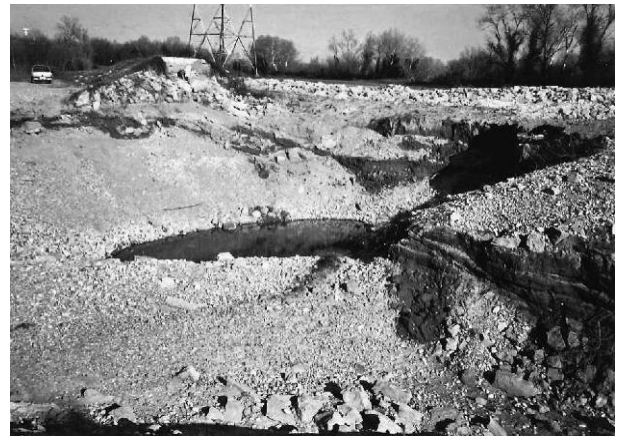
PHOTO 7 : DIGIE DE SAINT-JUST – DÉTAIL DE LA BRÈCHE N°1
