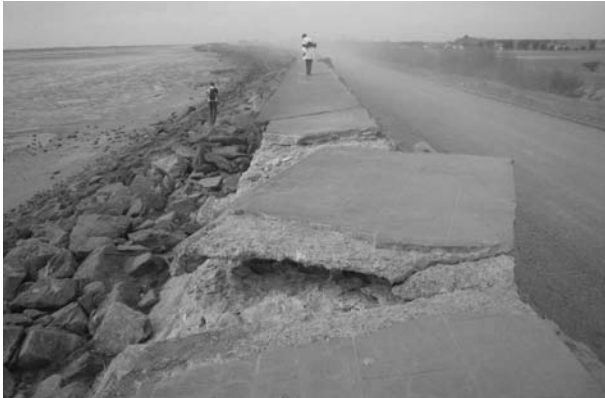
FIGURE 8 : DESTRUCTION DE LA BANQUETTE BÉTON DE LA DIGUE DU GÉNIE - L'AIGUILLON-SUR-MER (85)
