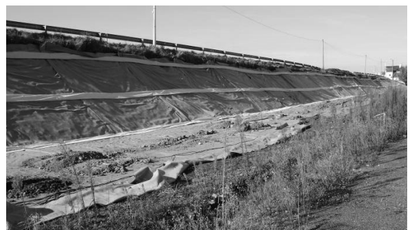
FIGURE 6 : LES TROIS NIVEAUX DE BANDES CAPTEUR INSTALLÉES SUR LE TALUS AVAL
