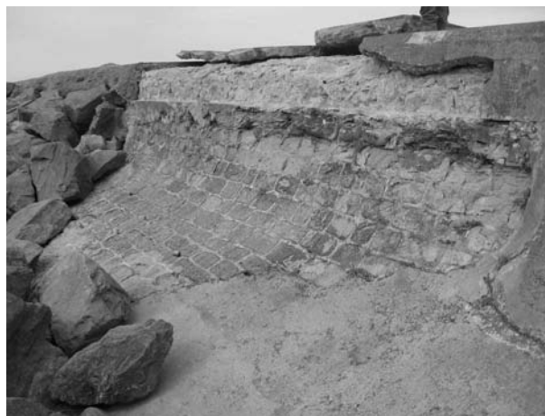
FIGURE 11 : PARTIE DE LA DIGUE DU GÉNIE SANS CARAPACE COMPLÈTE EN ENROCHEMENT AYANT SUBI UN ARRACHEMENT DE SON REVÊTEMENT BÉTON - L'AIGUILLON-SUR-MER (85)
