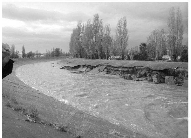
FIGURE 7: DESTRUCTION DES DALLES BÉTON ET ÉROSION DU REMBLAI DE LA DIGUE
