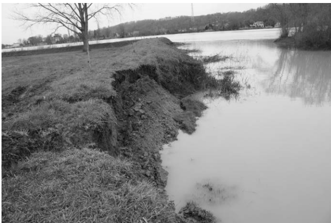
FIGURE 3: EFFONDREMENT RECENSÉ SUR LA DIGUE A PROXIMITÉ DE L'EMBOUCHURE.
