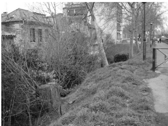
FIGURE 4: VUE D'UNE SOUCHE D'ARBRE DE GRANDES DIMENSIONS PRÉSENT SUR UNE DES DIGUES.
