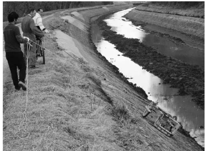
FIGURE 3 : VUE DE LA DIGUE ET DU CANAL VIDANGE AVEC ACQUISITION DES DONNEES AU RADAR SUR LE PERRÉ.
