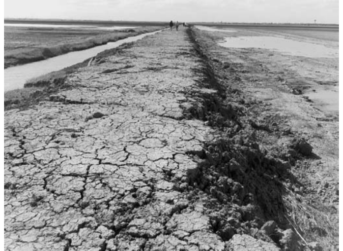
FIGURE 2: VUE D'UNE CRÊTE DE DIGUE EN TERRE SUBISSANT L'APPARITION DE CREVASSES (AUTEUR : F. CLÉMENT, CETE DU SUD-OUEST)
