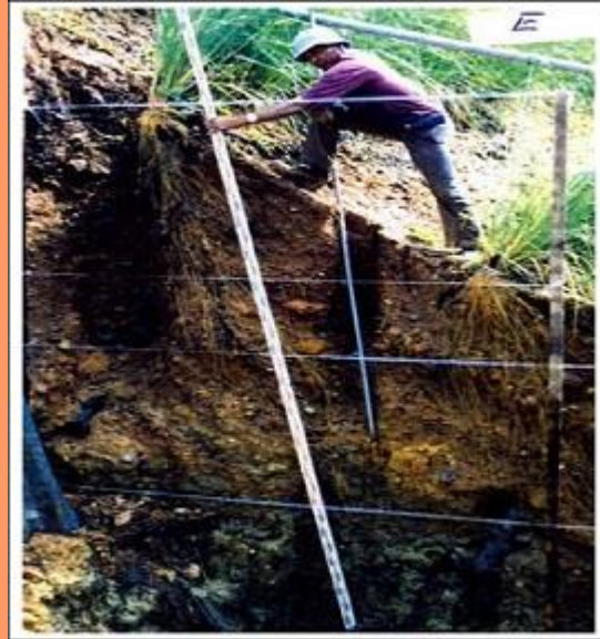
Coupe verticale sur un remblai montrant une croissance racinaire de 3,6m pour un vétiver de 8 mois.
