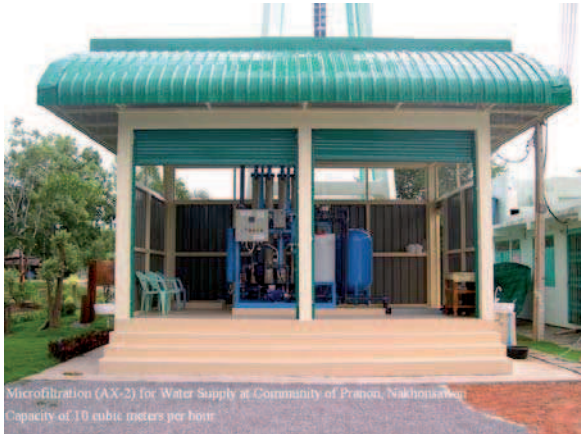
Photo 1 – Système membranaire du village de Pranon, Thaïlande d'une capacité de 10 m 3 /h
