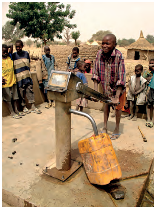
Forage équipé d'une pompe à motricité humaine
