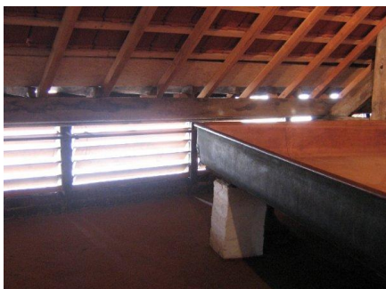
Figure N°7 : salle de refroidissement ventilée de la Brasserie Cantillon ; ( www.bieresetplaisirs.com )
