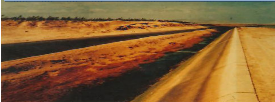
Photo n°4 : Envaselement du canal d'irrigation de Massa.
