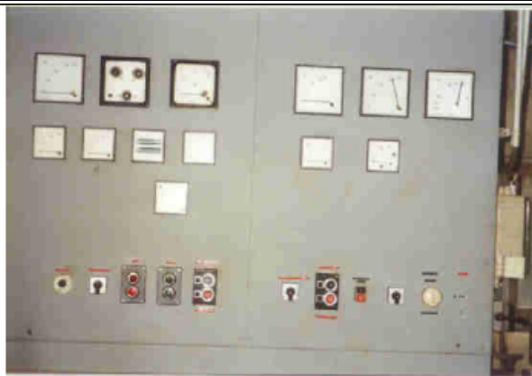
La partie droite du tableau montre l'armoire de commande de la turbine OSSBERGER.
