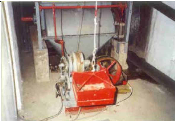
Vue du mécanisme à levier de commande de la fermeture de la turbine et du contrepois qui permettra une fermeture rapide en cas de problème.
