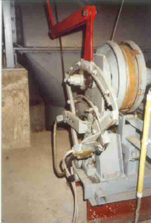
Vue de la fin de course qui limite l'ouverture et la fermeture de la turbine.
