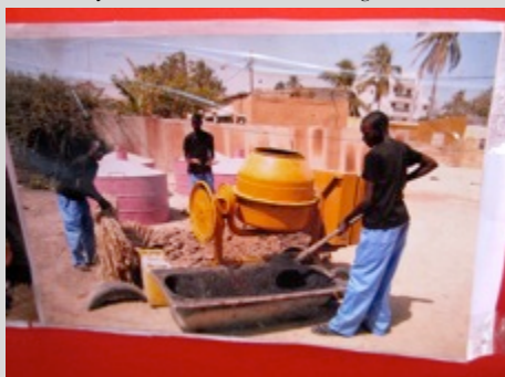
Baignoire servant de mélangeur à côté du mélangeur mécanisé (Brades - Sénégal)
