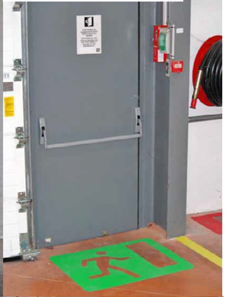
Signalisation des sorties de secours
