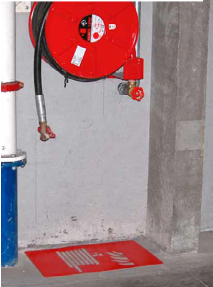
Signalisation des Robinets d'Incendie Armé
