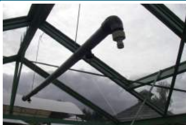
Rampe de brumisation
