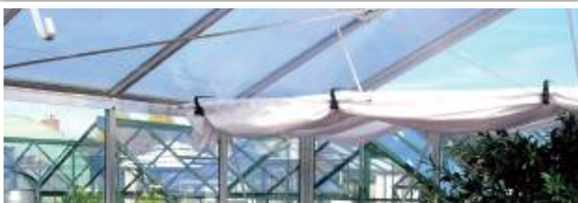
Toile d'ombrage gouttière avec toiture polycarbonate
