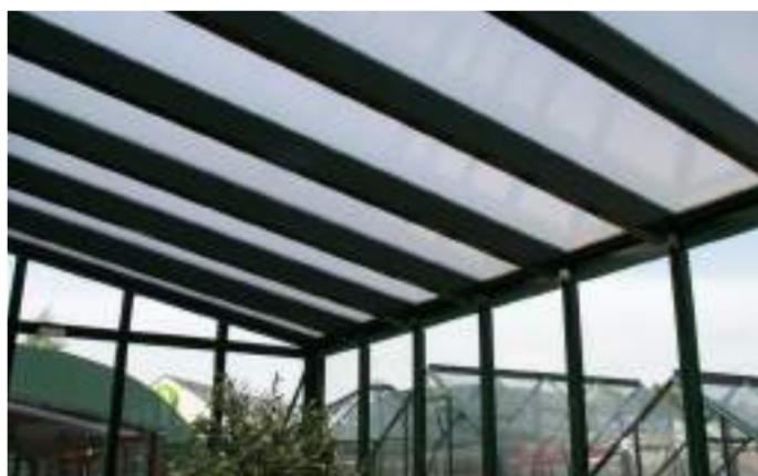
Toiture en polycarbonate de 8mm et parois en verre trempé de 4mm
